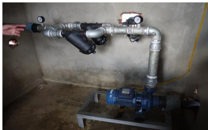
写真3：ポンプと送水管
